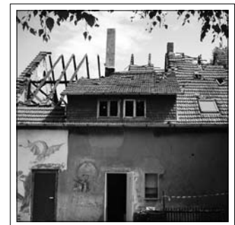
Gebäude der Tierpension der AIDS-Hilfe Bielefeld nach dem Brandanschlag
